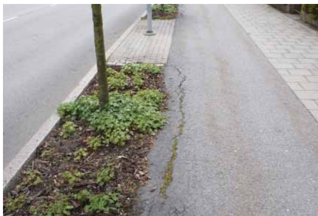
Kantskada på cykelvägen längs Kristianstadsvägen, Ystad
